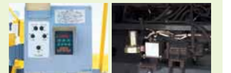
コントロールボックス ガスバーナプロア
